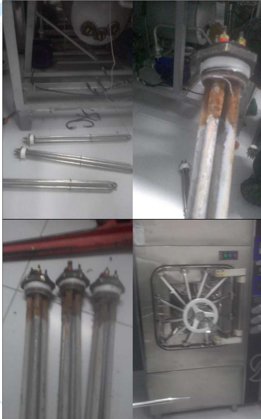
Manutenção preventiva na autoclave referente à troca da resistência - 28/04/2021
