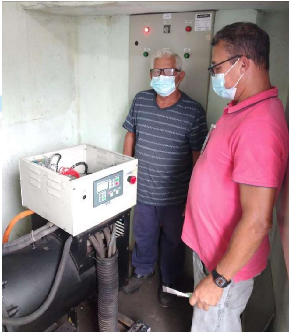
Teste semanal do gerador de energia
