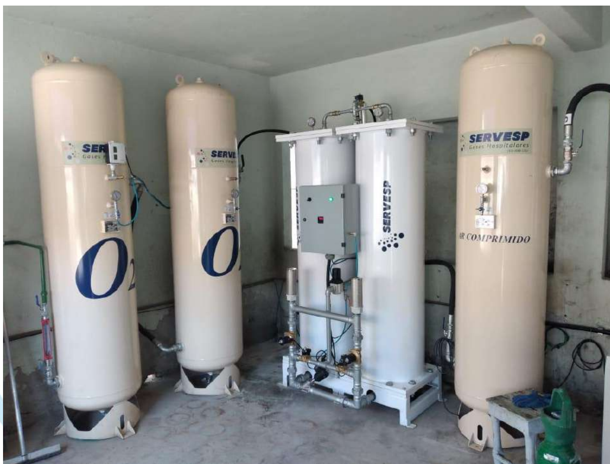
Usina de Gases Medicinais
